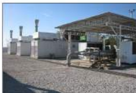
Figura 2 - Central de Aproveitamento Energético do Biogás do CTRs da BR-040 (PBH, 2019)
