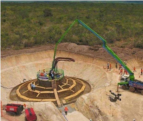
Figura 5 - Construção da base de uma das 94 torres eólicas do Parque Novo Horizonte
