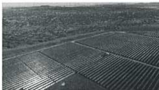
Planta fotovoltaica En Merida, Badajoz 105 MW
