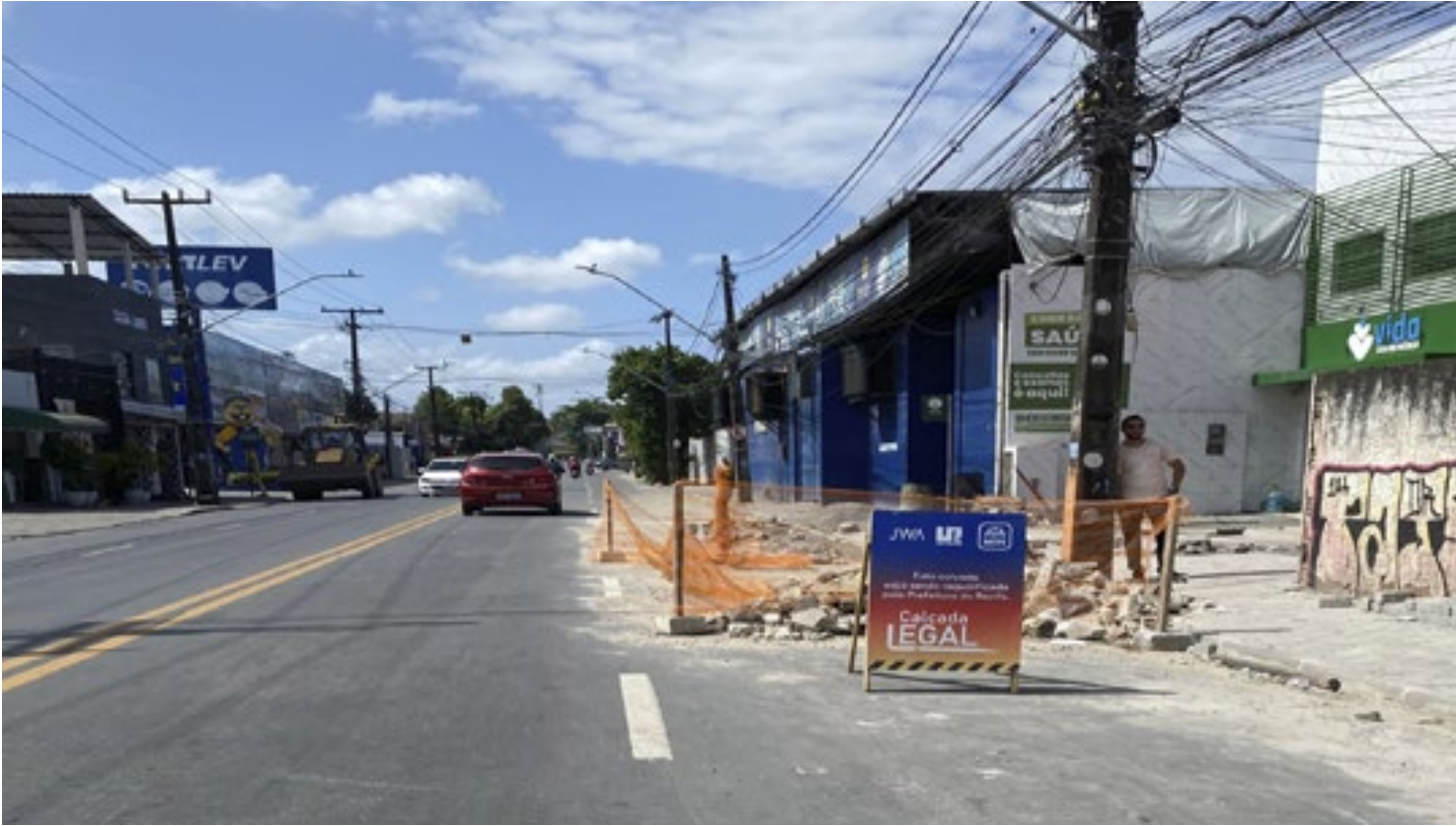
Obra atrasada da Prefeitura do Recife interdita faixa de avenida movimentada
