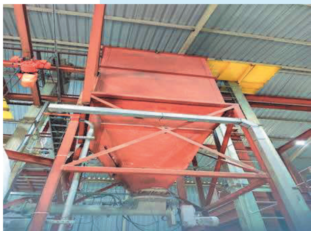
Silo em aço carbono
