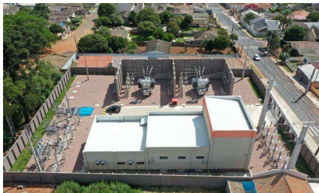
Foto: Subestação Léa Martins, em Ponta Grossa
