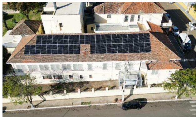
Usina Fotovoltaica no Hospital Dr. Lincoln Graça, em Joaquim Távora/PR
